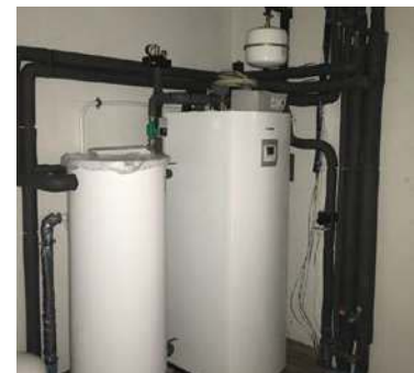
Erdwärmepumpe inkl. Pufferspeicher
